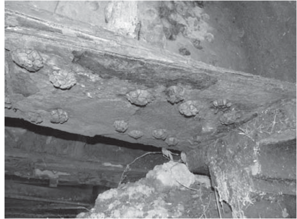
Рис. 4. Значна корозія металу з ослабленням усіх елементів
