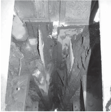
Рис. 1. Пошкодження елементів деформційних швів
